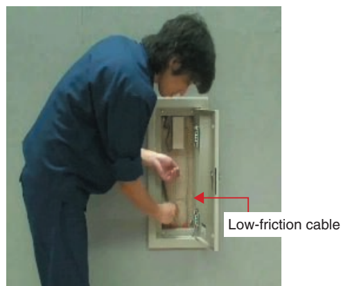
Fig. 6. New wiring method.
